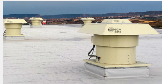
EVACUACIÓN DE HUMOS Silo Inditex, Madrid
